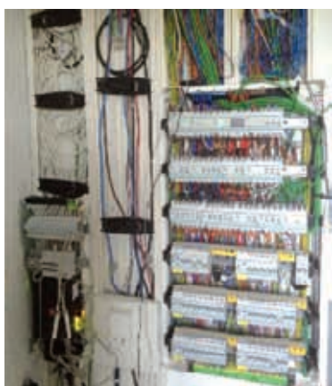
Armoire électrique courant fort , courant faible et domotique en cours de réalisation.
